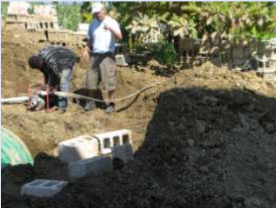
Es fehlen Wasserpumpen
